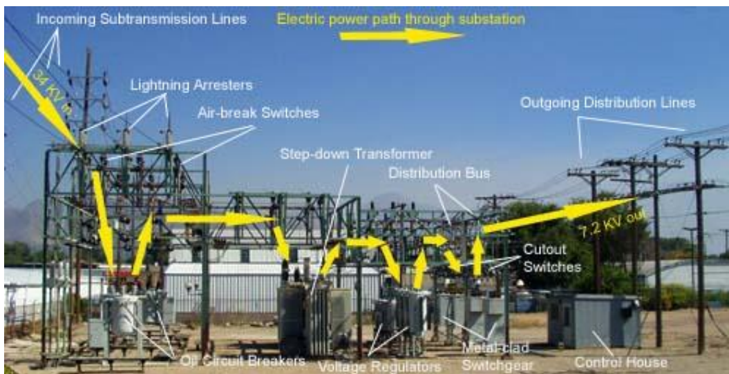
Hình : Trạm biến áp
