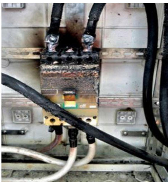
Hình 1.20: Sự cố cháy nổ CB nguồn do chạm pha
