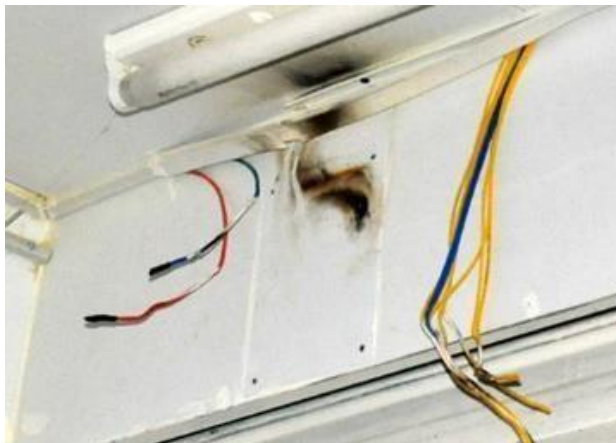
Hình 1.21: Sự cố cháy nổ do đấu nối dây dẫn điện không đúng kỹ thuật
