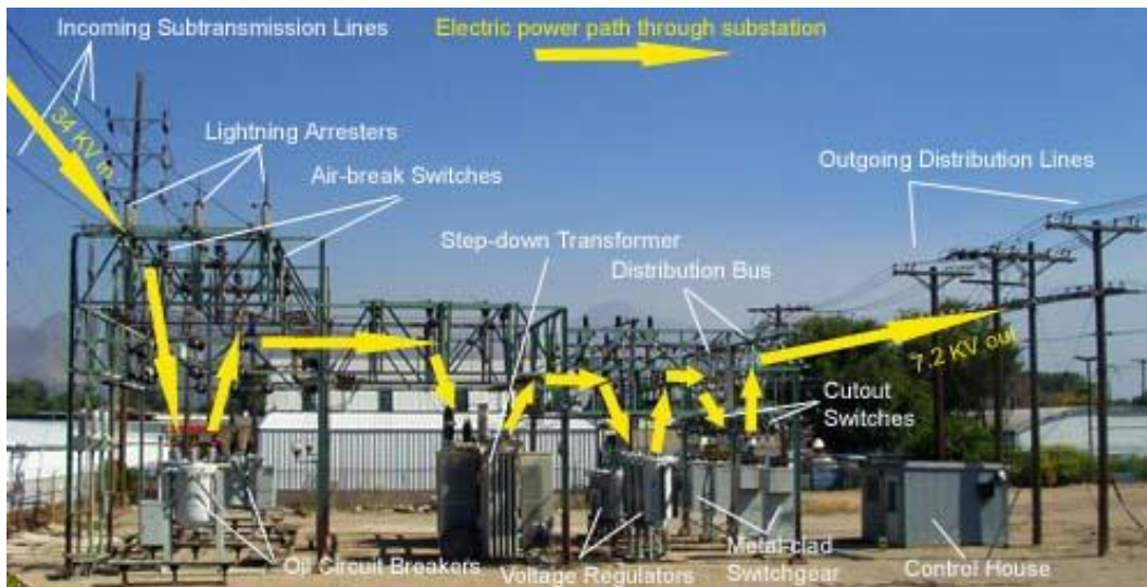
Hình : Trạm biến áp
