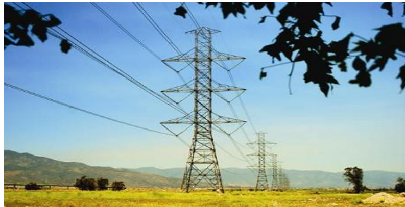
Hình 1-11. Đường dây dẫn điện trên không
