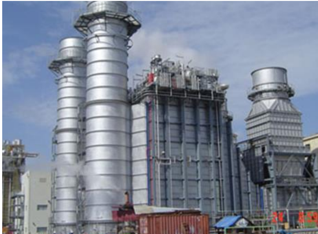
Hình 1. Nhà máy nhiệt điện
