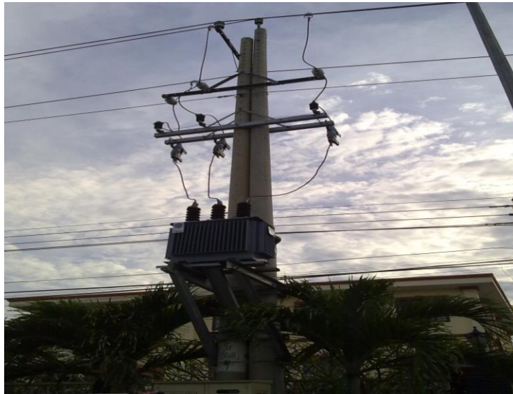
Hình 2-10. Trạm giàn S_{dm} \leq 400 kVA, đo đếm hạ thế
