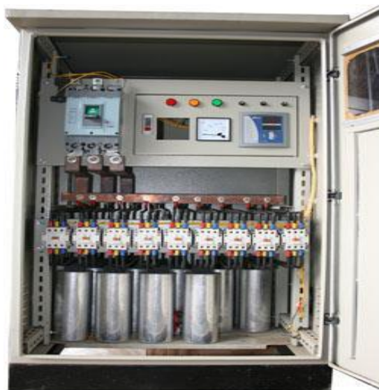
Hình 2.4: Tủ tụ bù
