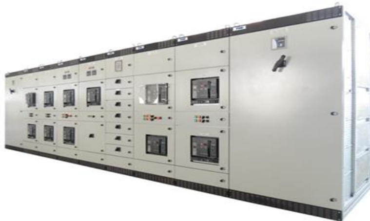
Hình 2.7: Hình ảnh tủ MSB
