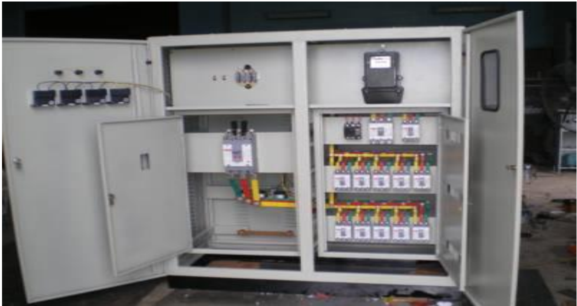
Hình 1.1: Hình ảnh tủ điện phân phối chính MSB
