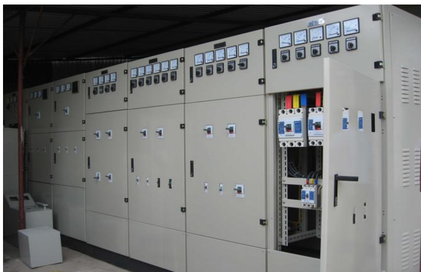
Hình 1: Hình ảnh về tủ điện
