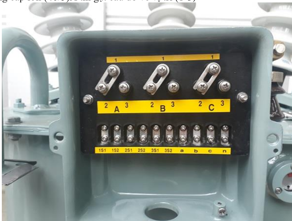
Hình 4.1: phần đấu nối phía sơ cấp của MOF 2 cấp loại 10 cọc
