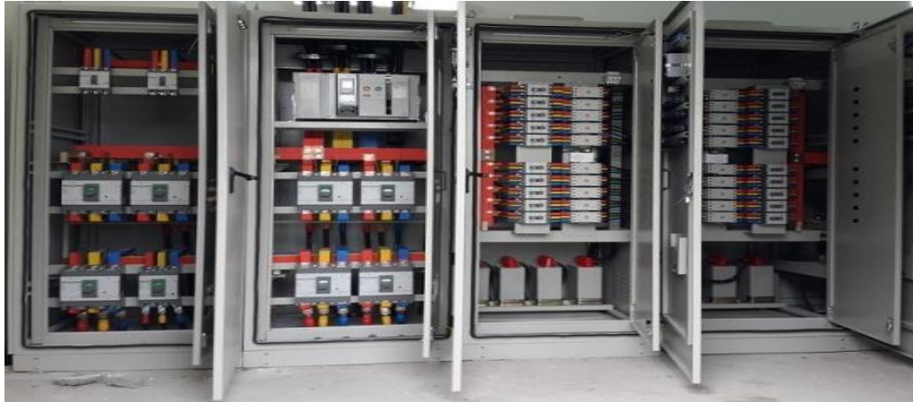
Hình 2.3: Hình ảnh tủ điện chuyển mạch ATS
