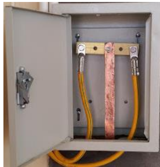
Hình 3.4.7: Hộp kiểm tra điện trở
