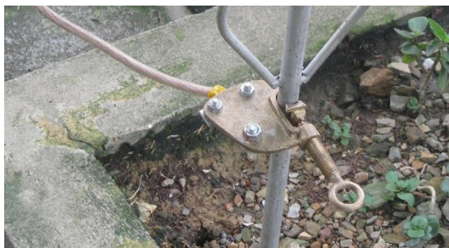
Hình 4.4.2: Cọc tiếp địa
