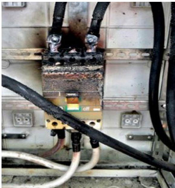
Hình 1.20: Sự cố cháy nổ CB nguồn do chạm pha
