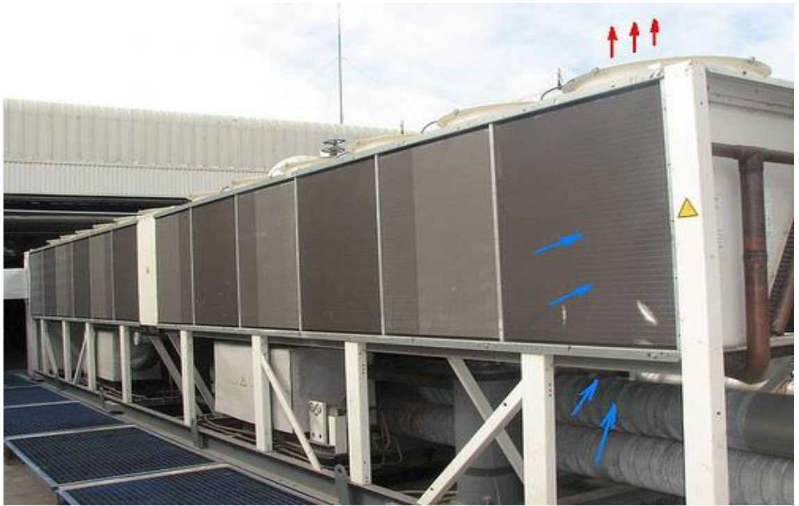
Hình 1.16: Tổng quan của 1 Air cooled chiller 400 ton. Trên hình nước được cấp vào theo mũi tên xanh và ra theo mũi tên đỏ.
