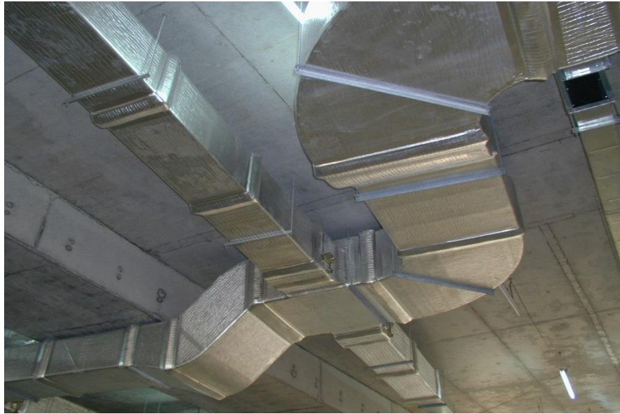
Hình 1.11: Kênh dẫn ống gió lắp đặt thực tế.
