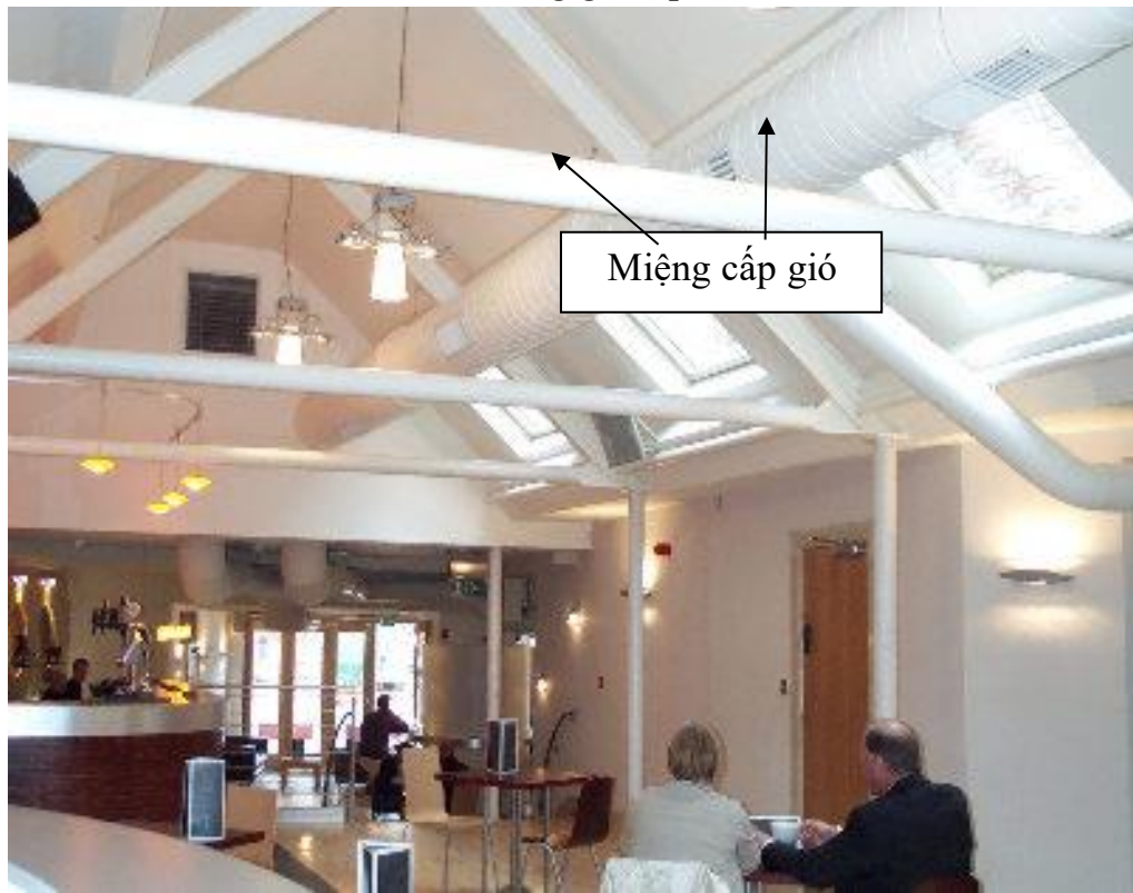
Hình 1.12: Kênh dẫn ống gió tròn lắp đặt thực tế.
