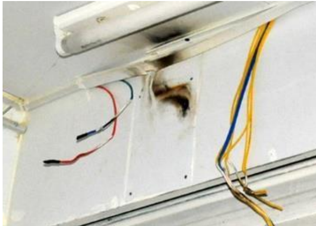
Hình 1.21: Sự cố cháy nổ do đầu nối dây dẫn điện không đúng kỹ thuật
