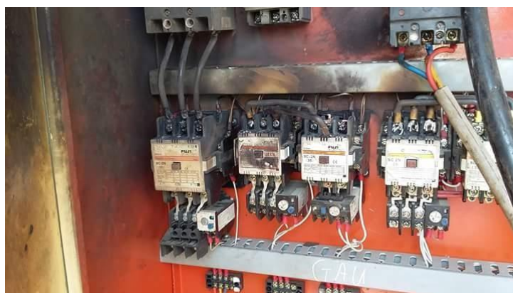
Hình 1.19: Sự cố cháy nổ do quá tải, chập điện và do vận hành, sử dụng không đúng nguyên lý - Cháy nổ CB nguồn do chạm pha.
