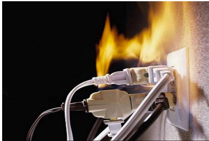
Hình 1.12: Sự cố quá tải
