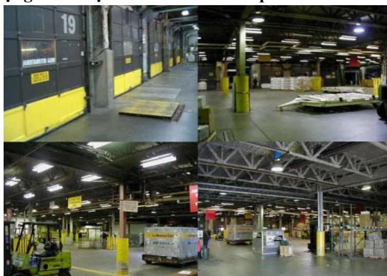
Hình 1.11 Hệ thống camera quan sát dành cho kho hàng, nhà xưởng
