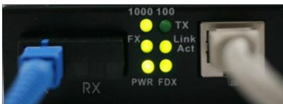
Hình 4.8 Converter quang điện 1G sáng đèn nhưng mất kết nối
