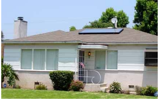
Hình 4.59. Hệ thống nước nóng lắp trên mái nhà.
