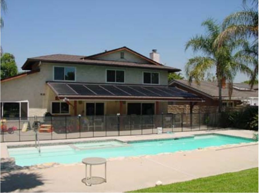
Hình 4.62. Hệ thống hâm nóng bể bơi
